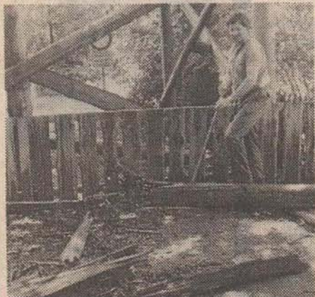
Ein völlig morscher Baumstamm war Stütze der Plattform.
